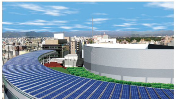
次世代型エコロジービルとして誕生した本社ビル屋上に設置された蓄電型太陽光発電システム。発電された電力を蓄電して利用する初めてのシステムで、二重層コンデンサを採用したエネルギー蓄電盤が付加されている
