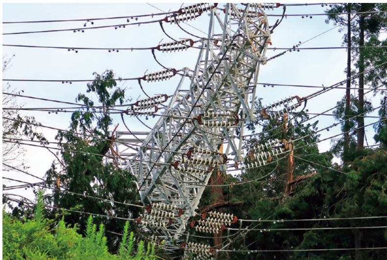
送電鉄塔2基 倒壊 (令和元年台風15号・君津市。山村氏撮影)
