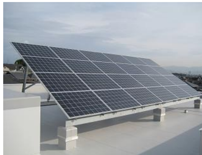
長岡今里支店屋上の太陽光パネル
