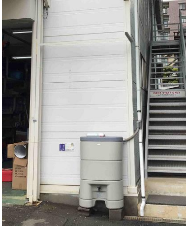
<雨水貯留タンク>
